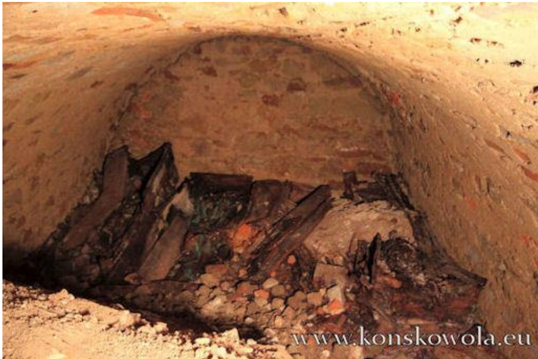
Widok na kryptę pod prezbiterium - fotografia wykonana przed wizytacją pracowników Wojewódzkiego Urzędu Ochrony Zabytków
